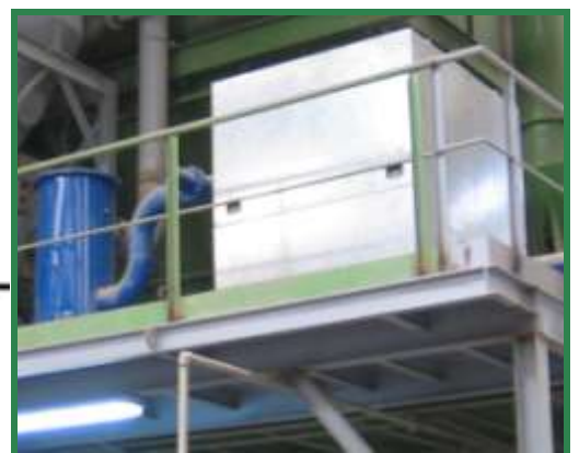
воздуходувная станция с двойной звукоизоляцией
